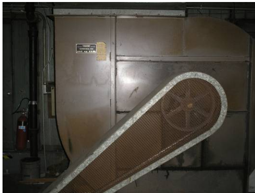
Fan on roof
