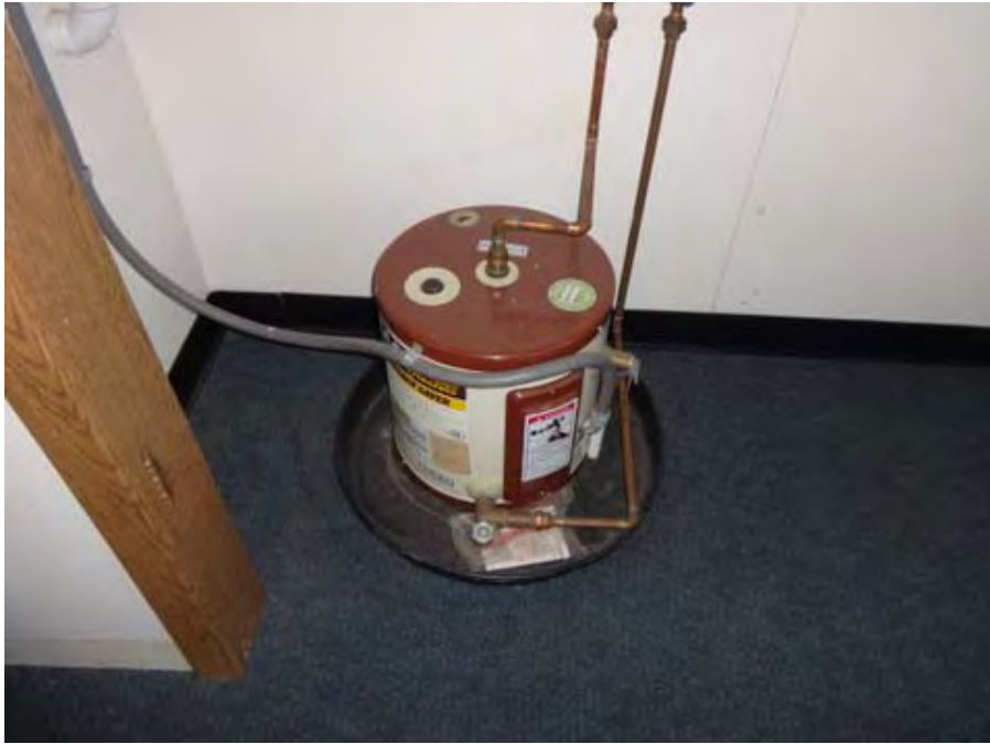
Tenant space water heater
