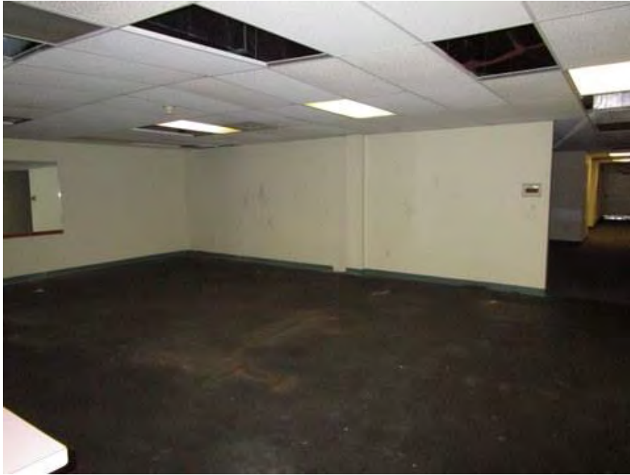
Vacant tenant space
