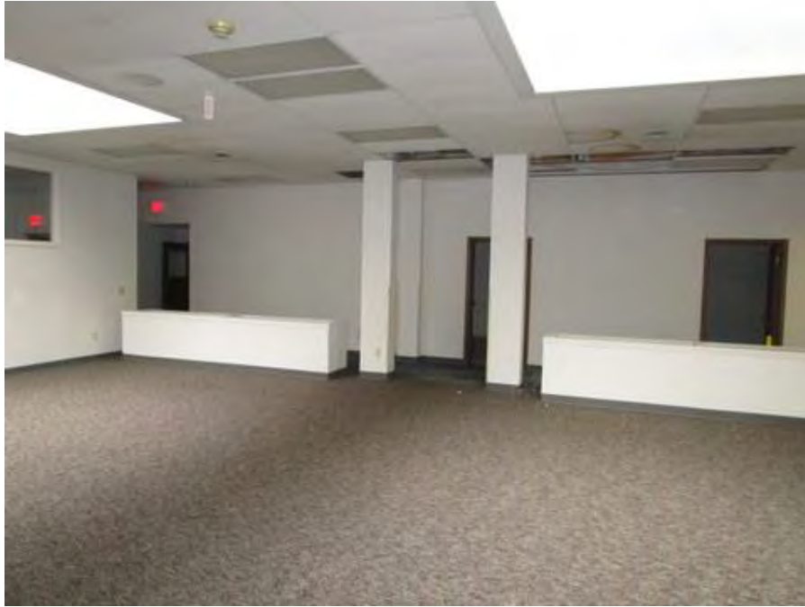
Vacant tenant space
